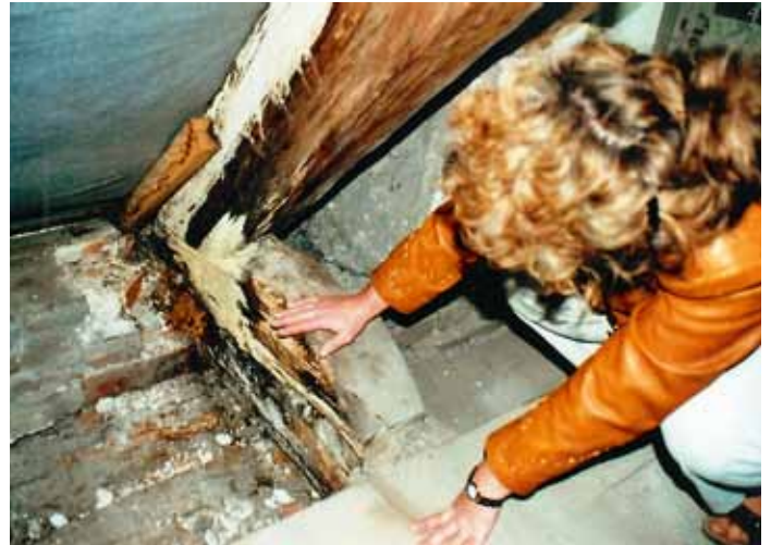
Starker Schwammbefall im Holz
